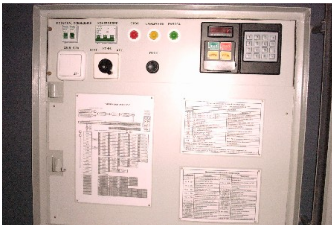
Рисунок 2.13 – Панель ЦВИЯ 301412.127, установленная на панель оператора
