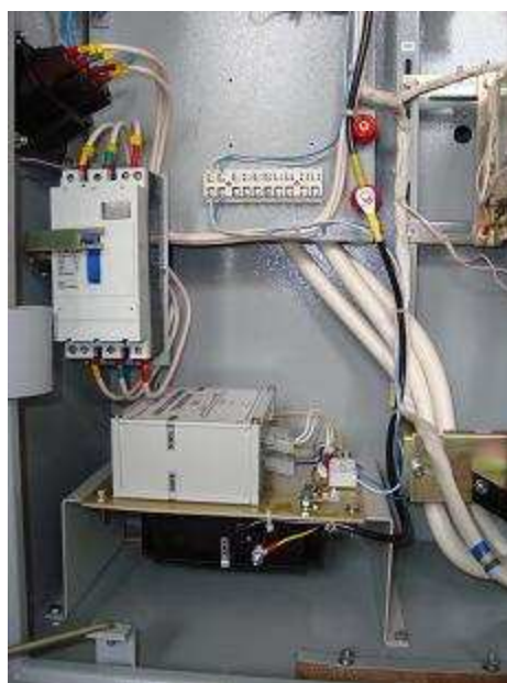
Рисунок 6. Общий вид установленного ТМС-Э5.
